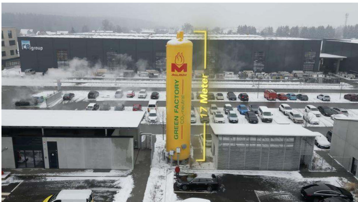
Der 17 Meter hohe Wärmespeicher
