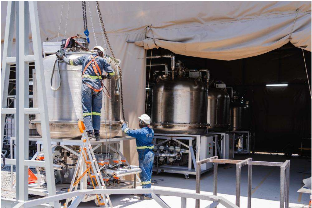
Die Anlage von Project Hummingbird im Great Rift Valley
